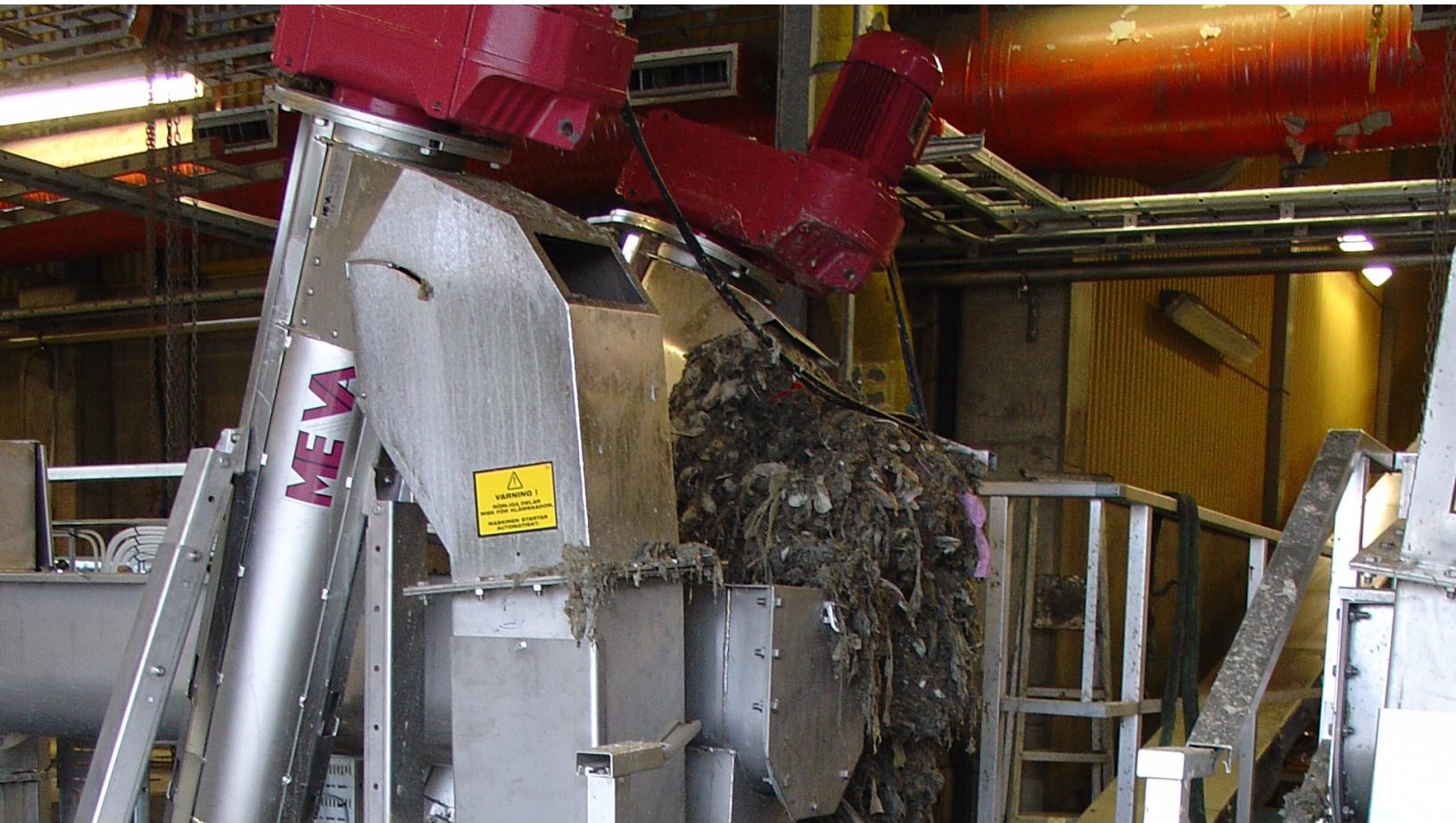
Skräp i rengaller på VA SYDs avloppsreningsverk
